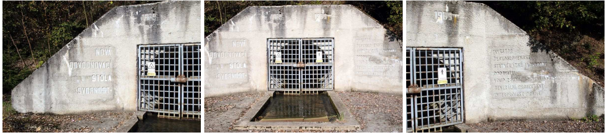
Nová odvodňovací štola Svornost
